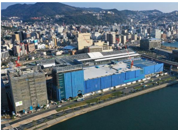
11月開業に向け建設が進む「出島メッセ長崎」（手前中央）。奥は新幹線ホームが整備中のJR長崎駅、橋を挟んで右は県庁＝長崎市
